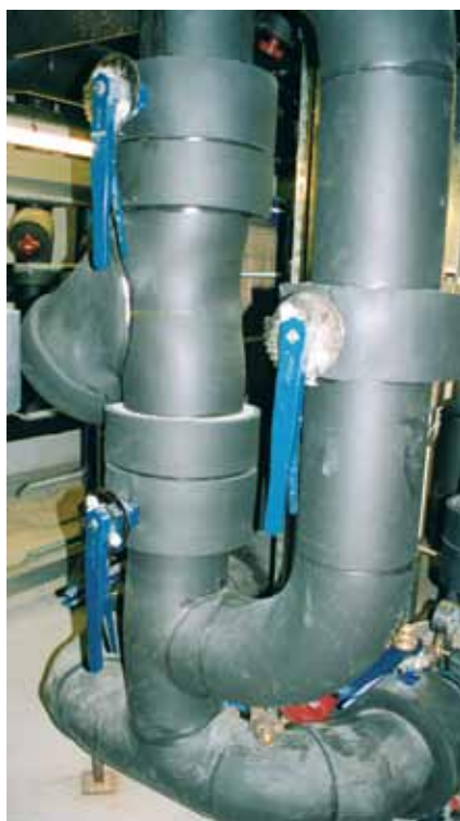
El aislamiento en las redes de transporte de los sistemas de climatización también es una medida prioritaria.
