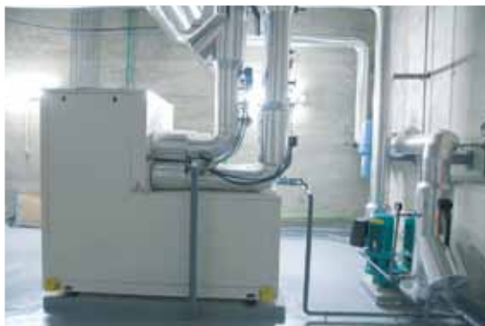
La instalación cuenta con una bomba de calor agua-agua con capacidad para la producción simultánea de frío y calor.
