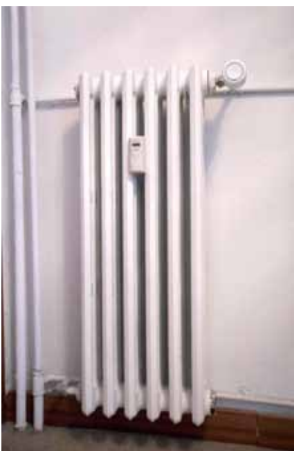
Las viviendas se han equipado con contadores de agua y repartidores de costes de última generación.
