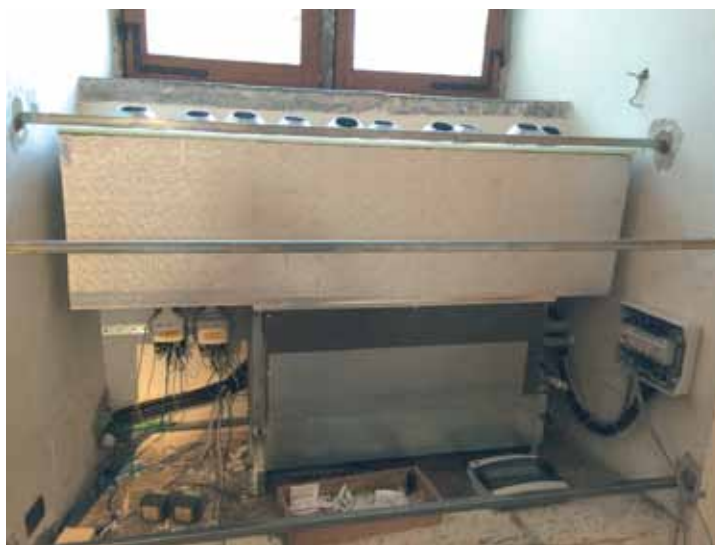
Sistema de humidificación ultrasónico, deshumidificadores y gestión y control electrónico de los sistemas de aire acondicionado.
